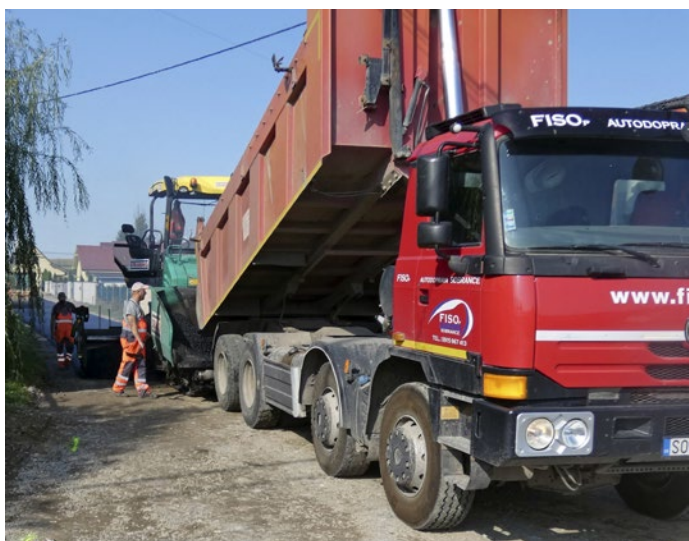
Usilovne sa obnovujú cesty aj v Čani, v poslednom čase sa pokládka asfaltových zmesí uskutočnila na ulici Vodnej, Ochrancov prírody, Malej až po športový areál
